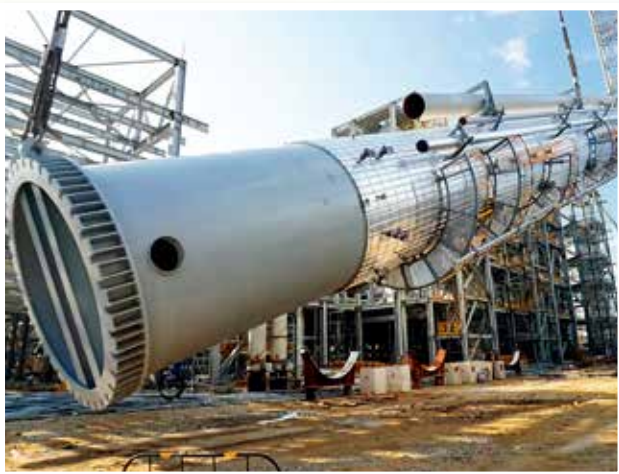
2022年1月，寰球工程六建公司吉化（揭阳）丙烯腈项目13万吨/年丙烯腈装置反应回收单元吸收塔顺利完成吊装，实现塔起灯亮。
