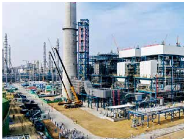
2021年12月31日，由寰球公司承建的广东石化项目动力中心1#、2#锅炉达到点火条件。
