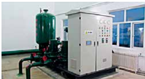
图9 注水站现场照片
