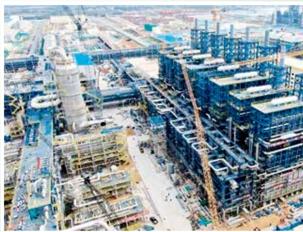
寰球公司乙烯分项目部全面掀起了大干快上的施工热潮。2022年1月份，压缩机及配套系统安装完成，乙烯变电所具备对外送电条件，单机试运正式开始。
